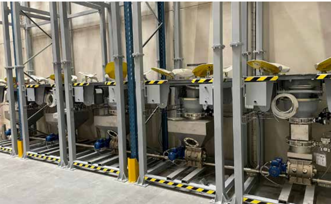
De uitdaging bij het uitwerken van de installatie lag vooral bij het feit dat op elke productielijn een afzonderlijke receptuur kan ingesteld worden en dat de lijnen op verschillende tijdstippen zullen worden gereinigd.
